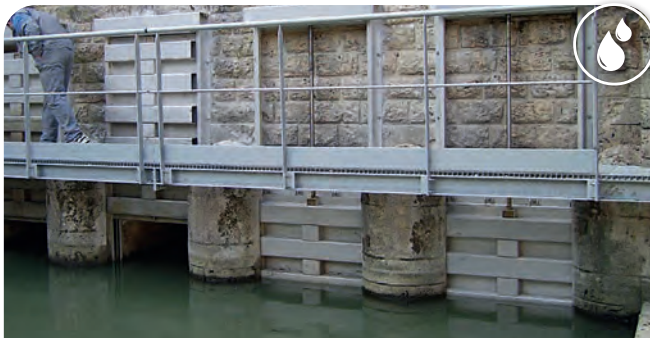
Isolement des réseaux (Vannes Murales) | Eau | FRANCE Network isolation (Penstocks) - Water - FRANCE
