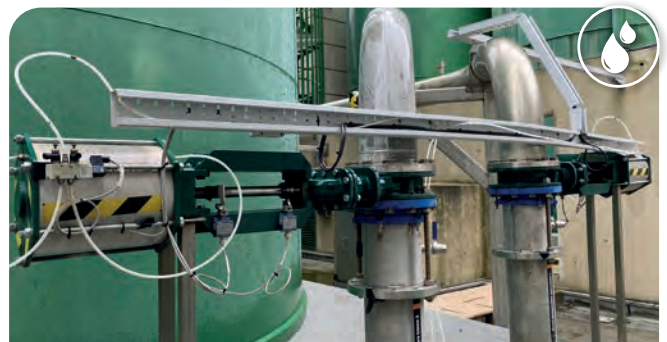
Station de traitement des boues | FRANCE Sewage sludge - FRANCE
